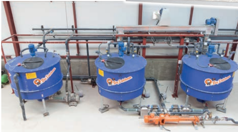
Blanderum: 2-tank anlæg med brugtvandstank
