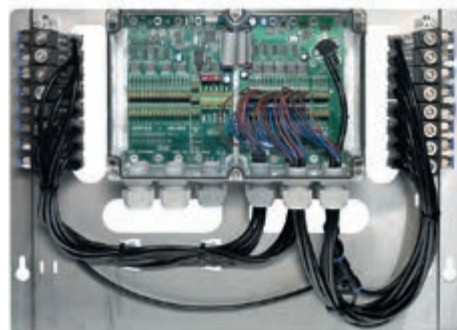
Ventilklynge til pneumatisk styring af foderventilerne
